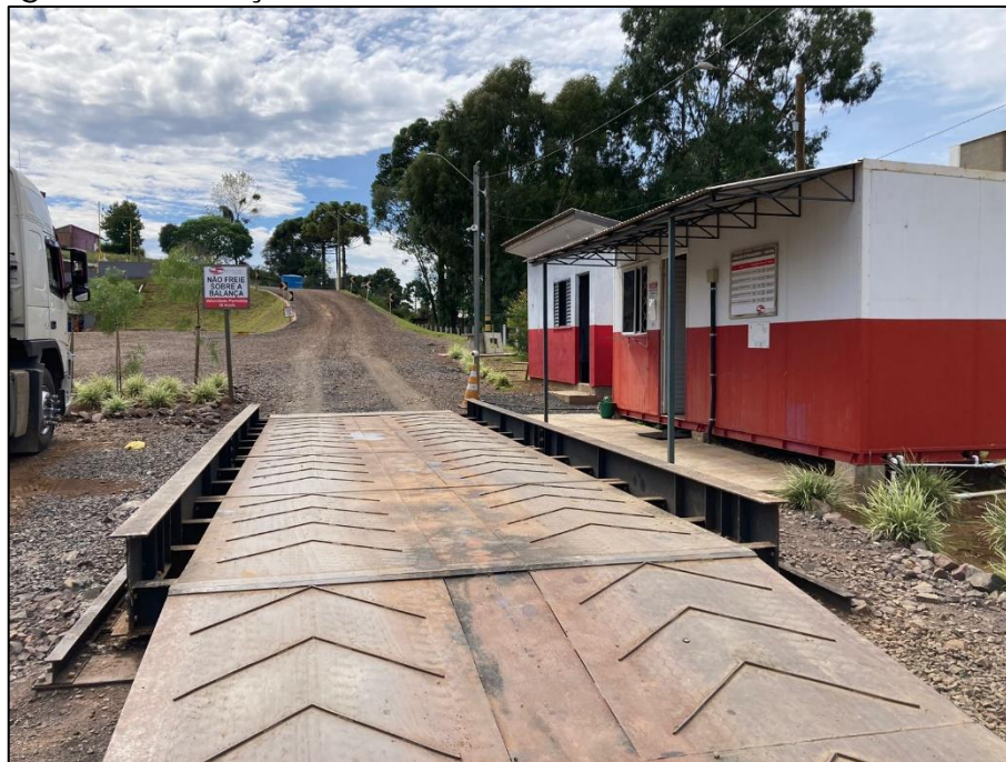
Figura 9 - Balança rodoviária instalada na Central de Transbordo
